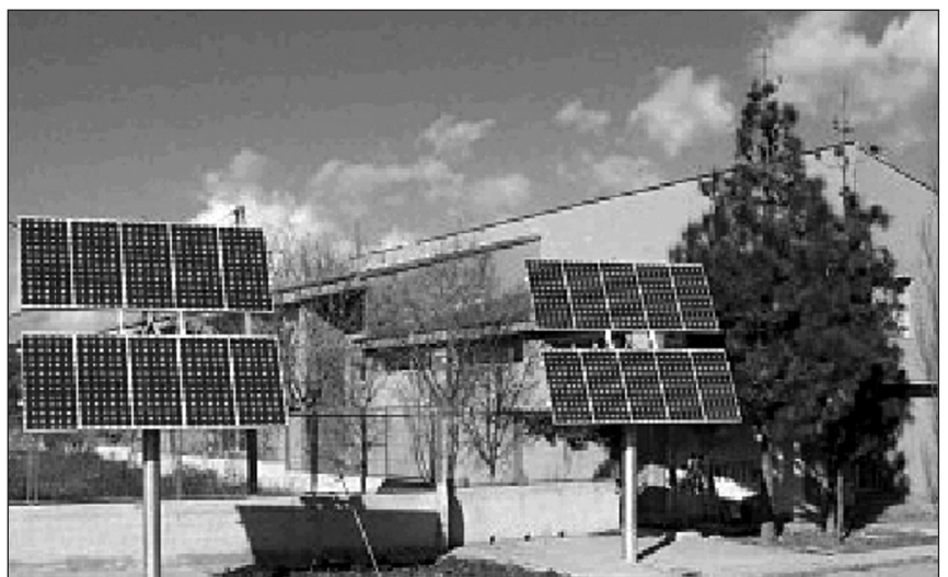
Instal·lacions fotovoltaïques a l'IES Lluçmajor. Des de es varen instal·lar, aquestes plaques han contribuït a l'estalvi de 10.150 kg de CO 2 i a la producció de 8.461 kWh. D'altra banda, són una eina didàctica de primera magnitud, tant per als alumnes del propi centre, com per als d'altres escoles i instituts que poden visitar la instal·lació. (HIPERVÍNCULO " http://weib.caib.es/Programes/ambientalitzacio/DOCUMENTS/Act11-02-2.pdf " " http://weib.caib.es/Programes/ambientalitzacio/DOCUMENTS/Act11-02-2.pdf ").
