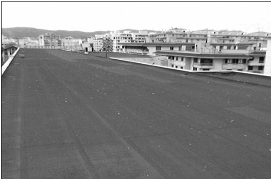
Immens terrat de l'IES Josep M a Llopart. Les possibilitats d'instal·lació i d'orientació de plaques fotovoltaïques, com es pot comprovar, són immillorables en aquest centre. El mateix passa a la majoria de centres educatius de les illes.
